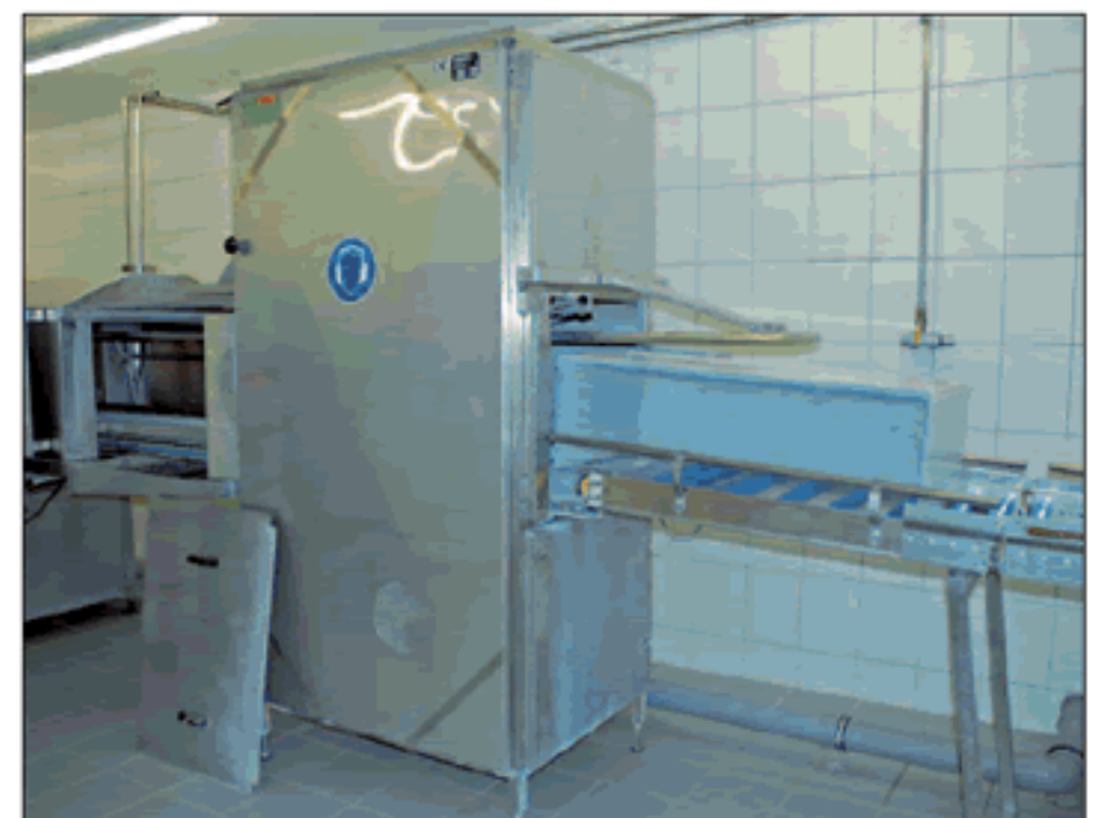
Die Waschstraße zur Säuberung und Sterilisierung der Zuchtboxen in Betrieb
