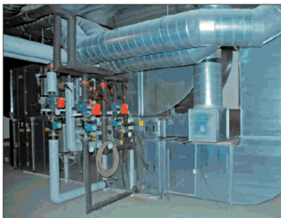
Blick in den Technikraum; hier laufen die Lüftung und Beheizung zusammen.
